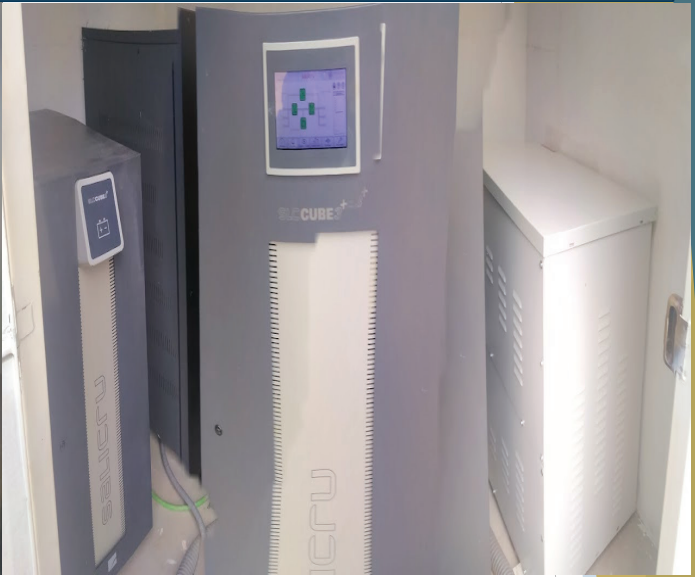
CUARTO DE UPS
